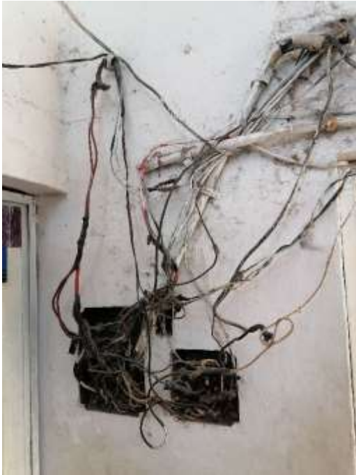
Estructura de cableado de corriente eléctrica, Centro Penitenciario "El Castillo", Sinaloa.
