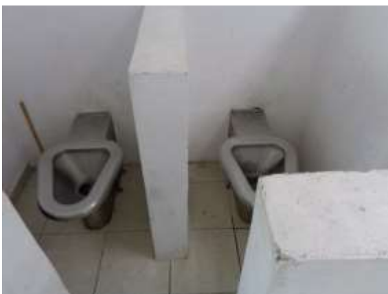
Sanitarios de la Estación Migratoria en el Estado de Querétaro. Visitas realizadas del 05 al 09 de octubre de 2020.
