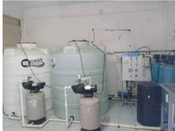
Filtros de agua del Hospital Psiquiátrico “Cruz del Norte”, en el Estado de Sonora. Visitas realizadas del 09 al 13 de noviembre de 2020.
