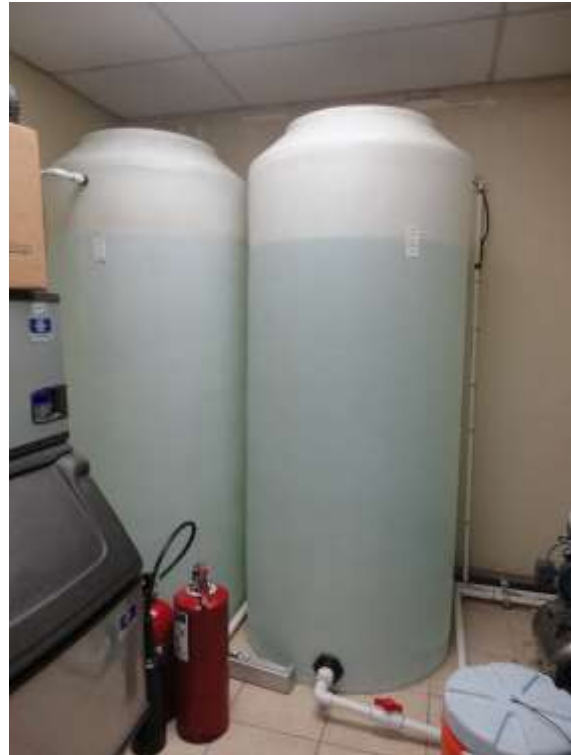
Filtros de agua - Albergue Temporal Mexicali en el Estado de Baja California. Visitas realizadas del 07 al 11 de septiembre de 2020.
