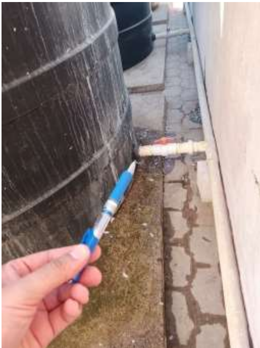
Contenedor de agua con fuga, Centro Especializado en Internamiento para Adolescentes "Hermosillo 1", Sonora.
