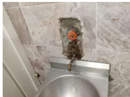
Llave de agua con fuga, Estación Migratoria en el Puerto de Veracruz.
