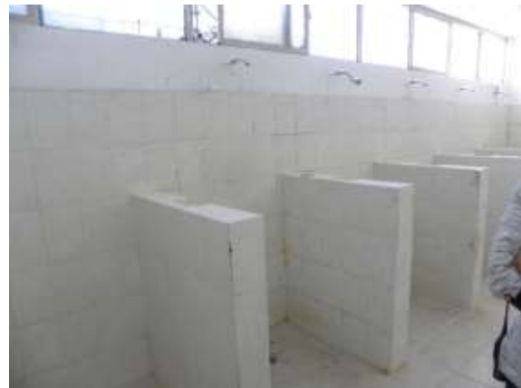
Sanitarios del Centro Varonil de Internamiento Especializado para Adolescentes Saltillo, en el Estado de Coahuila. Visitas realizadas del 19 al 23 de octubre de 2020.
