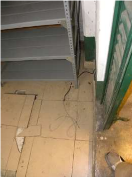
Cableado de corriente eléctrica, Oficina de Representación del Instituto Nacional Migración en Baja California Sur.
