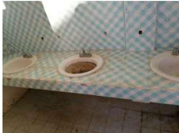
Lavabo sin mantenimiento, Ciudad de los Niños del Centro de Sinaloa, A. C., Sinaloa.
