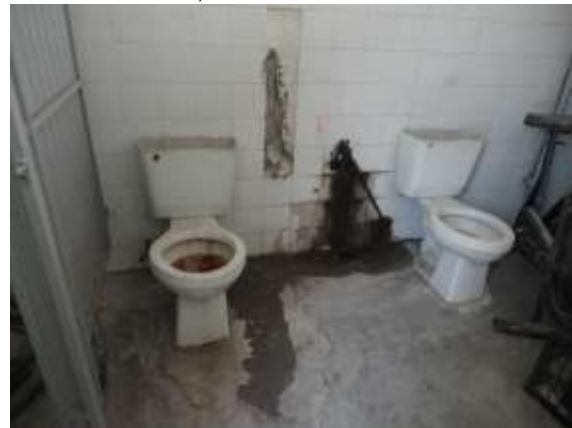
Condiciones de los sanitarios, Centro de Ejecución de Medidas para Adolescentes del Estado de Guerrero.
