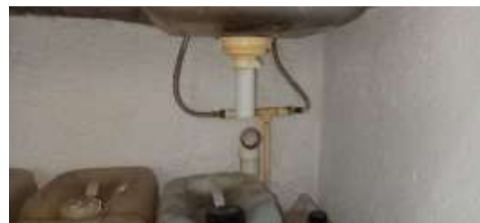
Lavabo sin mantenimiento, Estancia Provisional tipo B de Acapulco, Guerrero.
