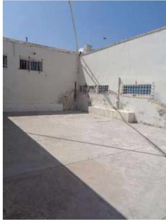
Infraestructura sin ventilación, Hospital de Salud Mental de Chihuahua.
