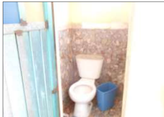
Sanitarios del CSH4
